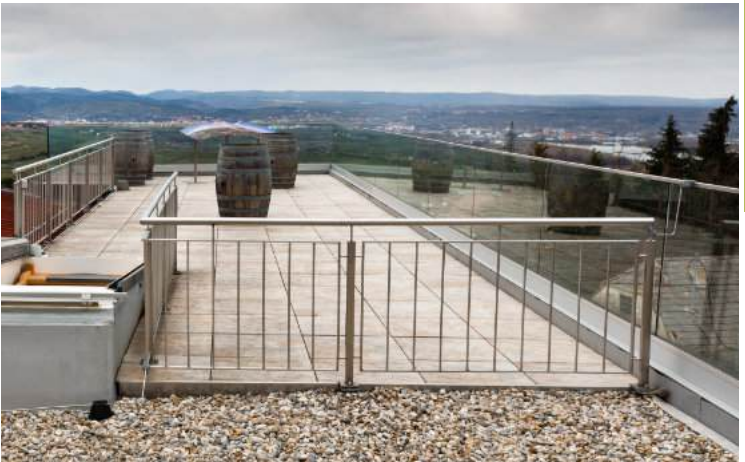
Terrassengeländer mit Edelstahl und Glas
